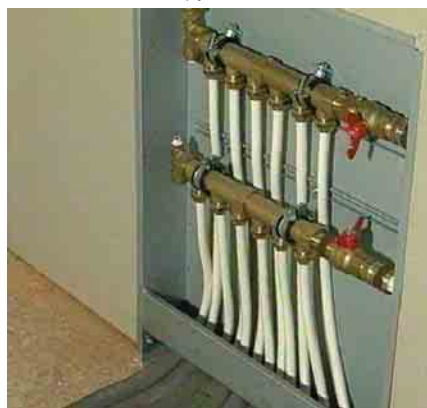
Гребенка в монтажном шкафу для подсоединения радиаторов
