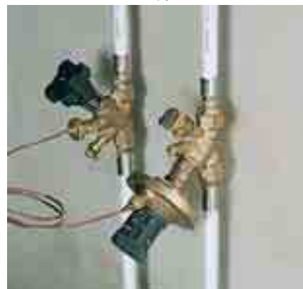
Подключение регулирующей арматуры на стойках
